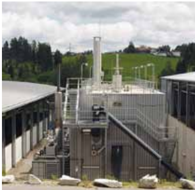
Grüngutvergärungsanlage des Abfallwirt- schaftsbetriebs Donau-Wald.
