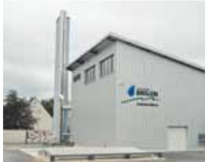
Das Holzheizwerk der Stadtwerke Brilon nutzt Hackschnitzel aus dem Bürger- und Energiewald.
