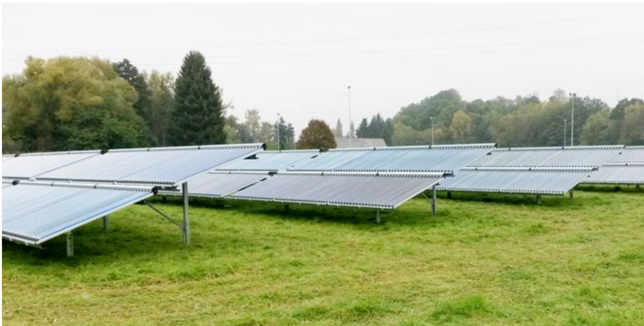
DAS SOLARTHERMISCHE FELD DECKT 20 PROZENT DES WÄRMEBEDARFS IN NEUERKIRCH UND KÜTZ
