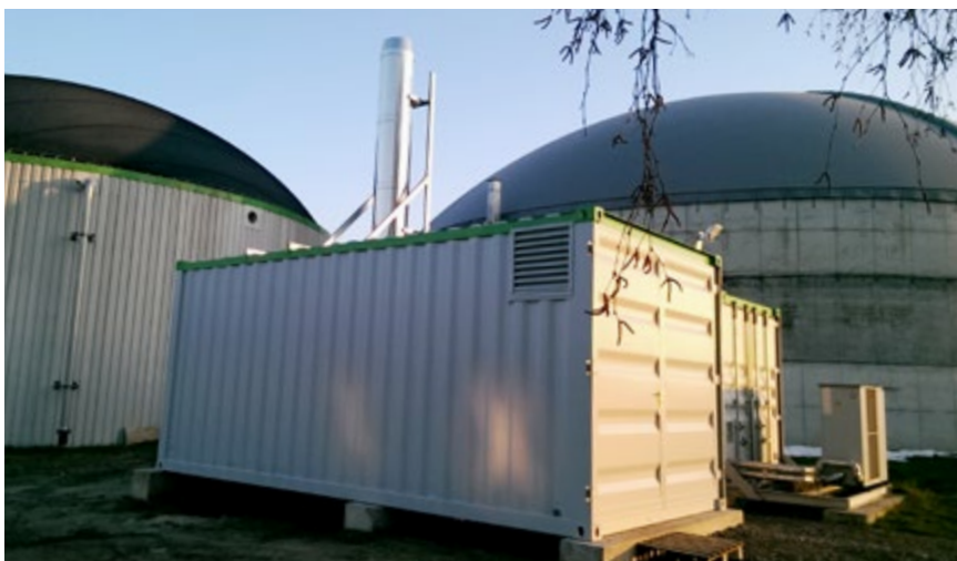
DAS BLOCKHEIZKRAFTWERK SORGT FÜR STROM UND WÄRME AUS BIOGAS
