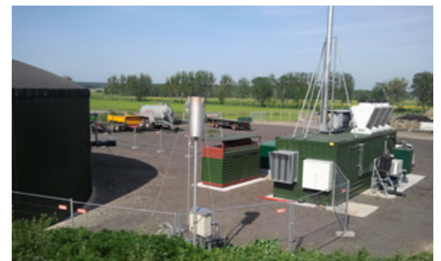
Ursprünglich eine Idee des Schwiegervaters: Die Biogasanlage des Brackx-Hofs kann heute rund 1.000 Haushalte mit Strom versorgen.
