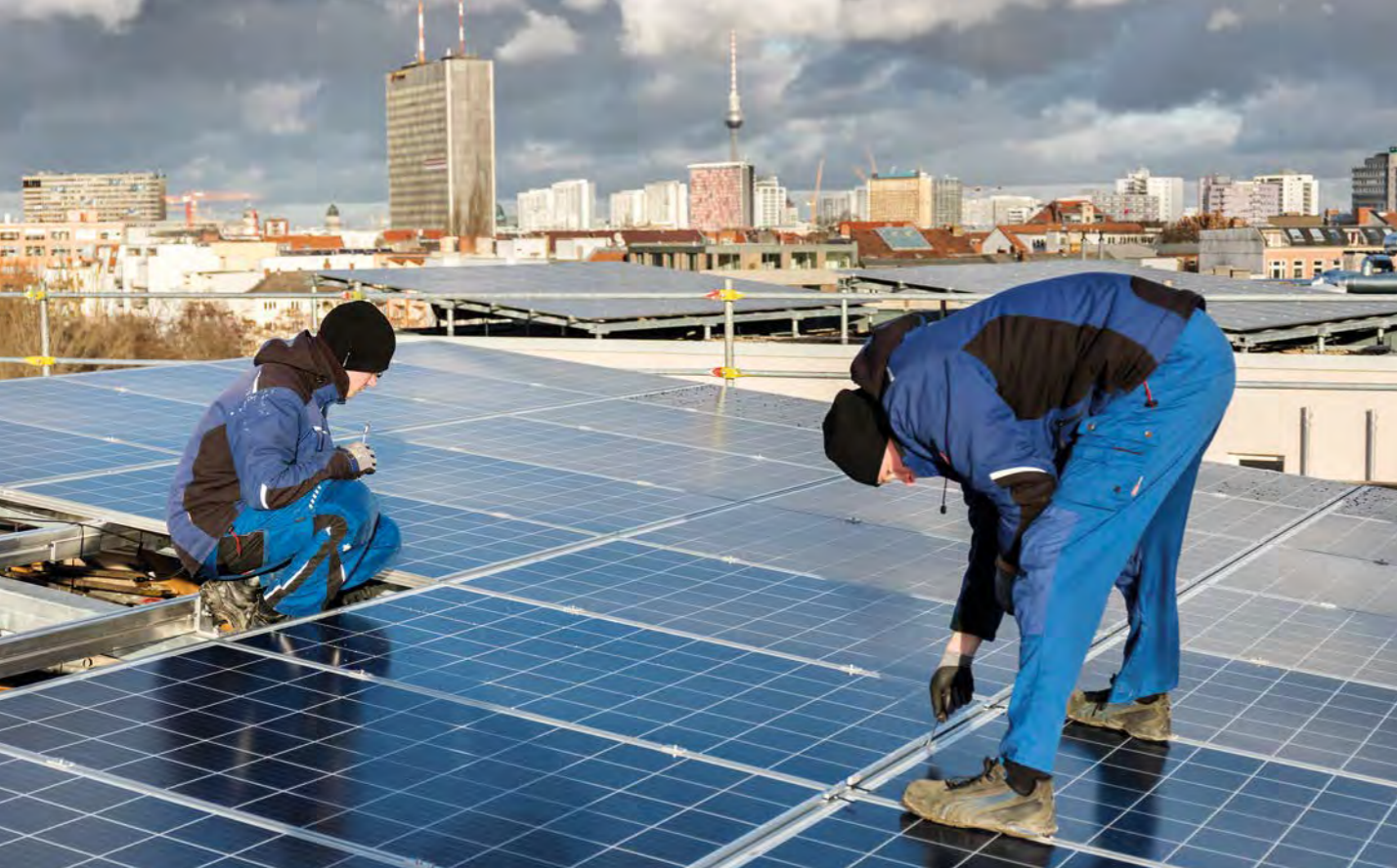
PHOTOVOLTAIKANLAGEN IN BERLIN KÖNNEN FÜR GÜNSTIGEN MIETERSTROM SORGEN.
