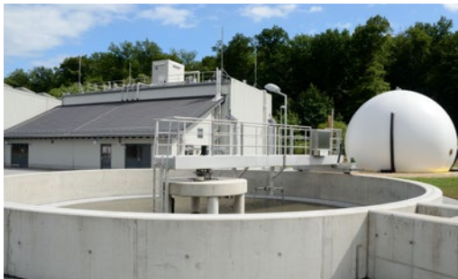
Vorklärung mit Gasbehälter und Faulturm der Kläranlage Selters Quelle: Verbandsgemeindewerke Selters
