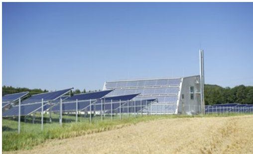
Das Kollektorfeld und die Heizzentrale in Büsingen sind Vorbild für innovative Wärmenetze in Baden-Württemberg.
