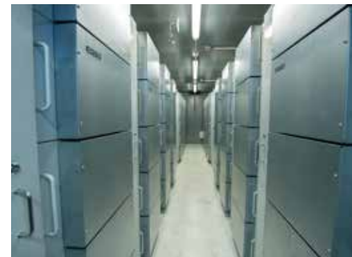
Batteriespeicher Neuhardenberg von innen Quelle: Upside Invest GmbH & Co. KG
