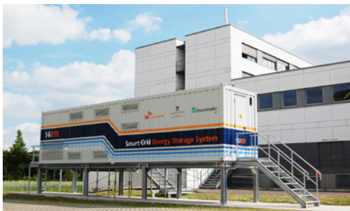
Der mobile 1-Megawatt-Speicher SGEES am Fraunhofer IFF in Magdeburg.
