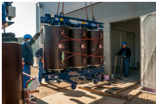
Trafolieferung: Die Fertigstellung des Schweriner Batteriespeichers.
