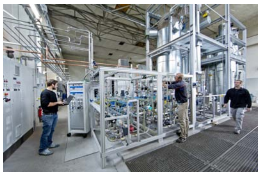
Power-to-Gas nah an der industriellen Nutzung: Die neue 250-Kilowatt-Anlage am ZSW. Links: ZSW-Forscher bei der Kontrolle der Gasmischung. Im Hintergrund die Methanisierungsanlage. Rechts: Elektrolyse zur Wasserstoffherstellung. Quelle: Zentrum für Sonnenenergie- und Wasserstoff-Forschung Baden-Württemberg (ZSW)
