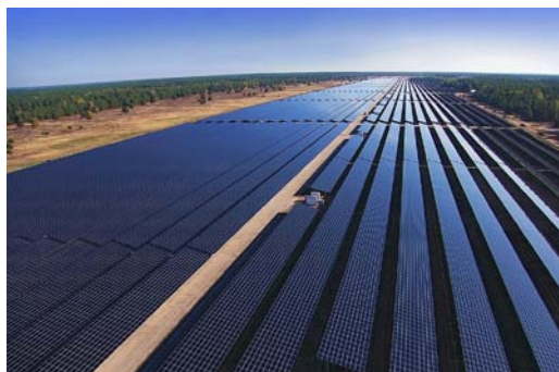
Bereitstellung von Strom und Systemdienstleistungen in einer Photovoltaik-Freiflächeanlage in Templin im Norden Brandenburgs
