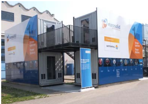
2-Megawatt-Batterie zur Speicherung überschüssiger Erneuerbarer Energie für ein virtuelles Kraftwerk Quelle: Vattenfall
