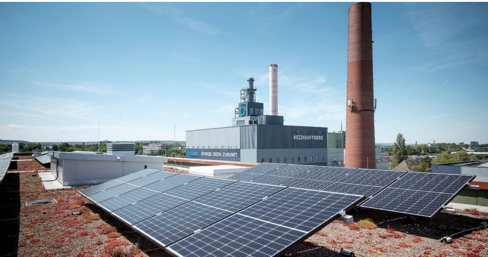
SOLARANLAGE MIT BLICK AUF DAS HEIZKRAFTWERK NORD DER STADTWERKE BONN
