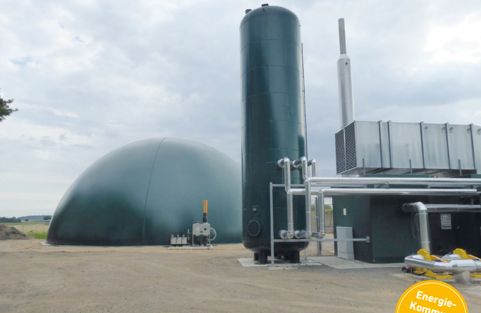
BIOGASANLAGE MIT SPEICHER DER LU TANGELN EG
