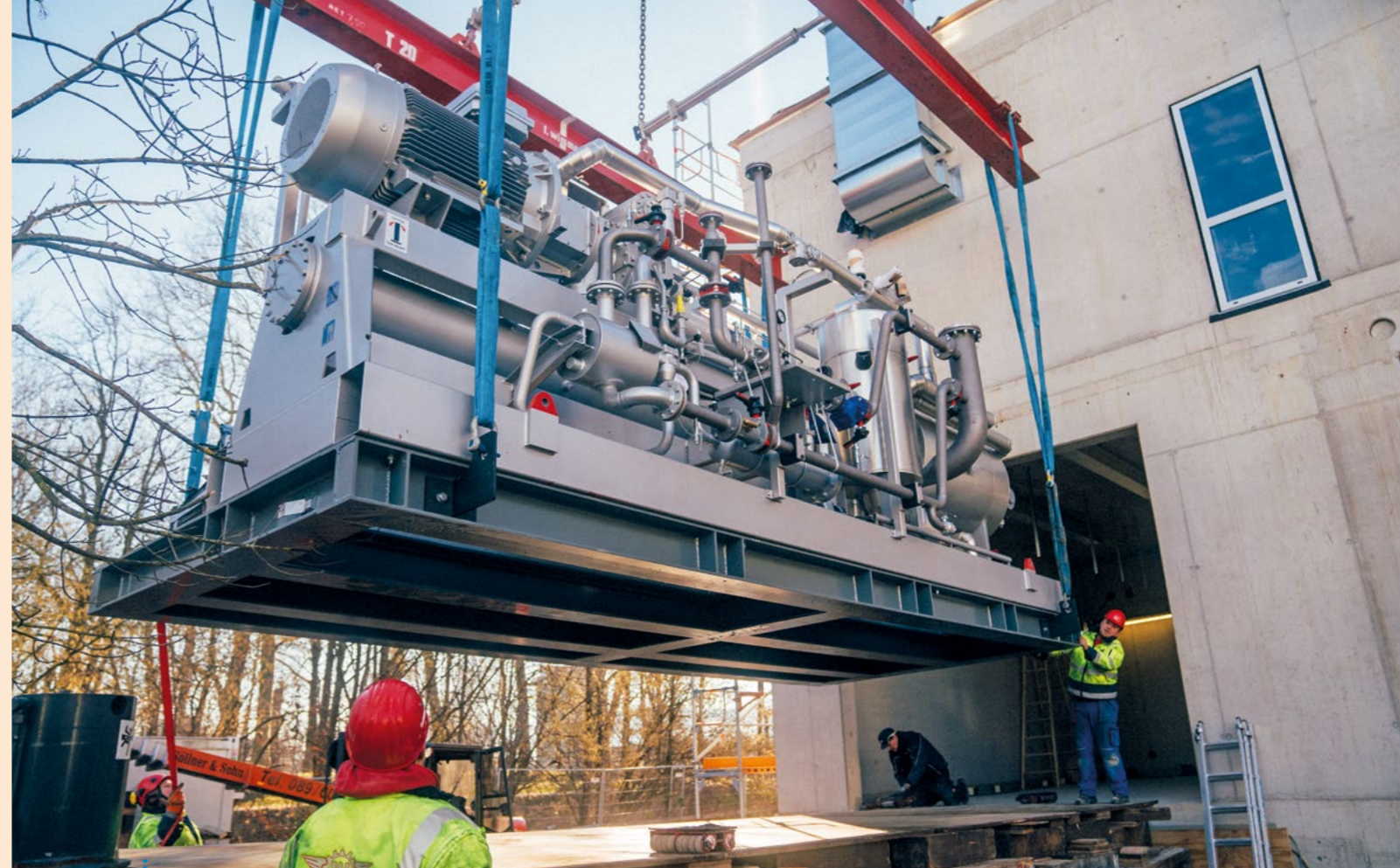
DIE STADTWERKE ROSENHEIM HABEN DREI GROSSWÄRMEPUMPEN IN DIE FERNWÄRMEEERZEUGUNG DES MÜLLHEIZKRAFTWERKES INTEGRIERT.
