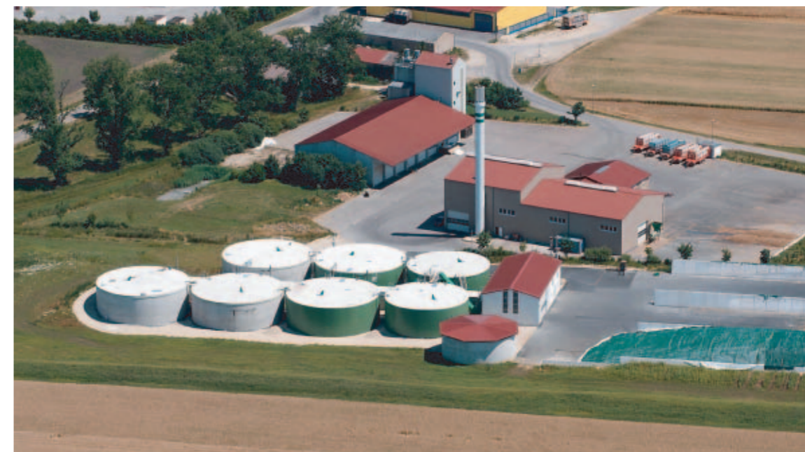
Strom und Wärme fürs Dorf: Eine Biogasanlage in Wechingen (Bayern).
