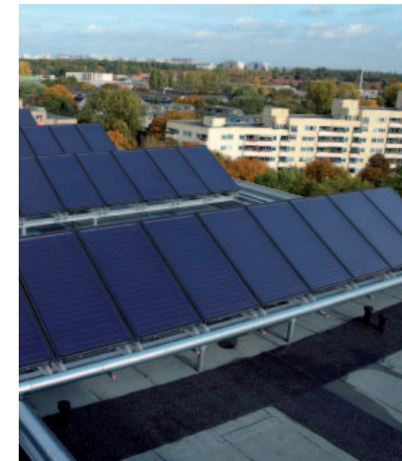
Solarthermieanlage auf dem Dach eines Mehrfamilienhauses.
