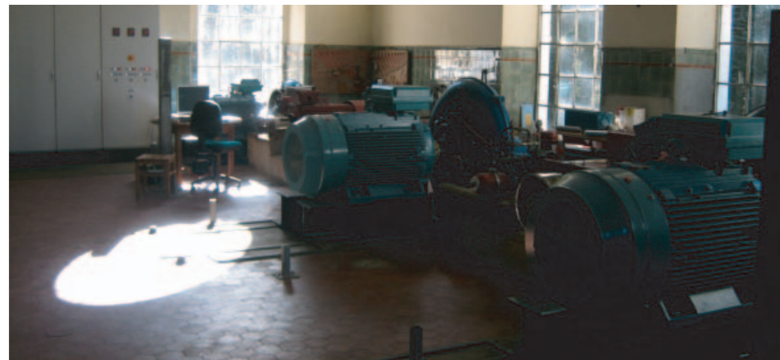
Eine Bürgergesellschaft hat das seit 1969 stillgelegte Wasserkraftwerk Vöhrenbach reaktiviert.
