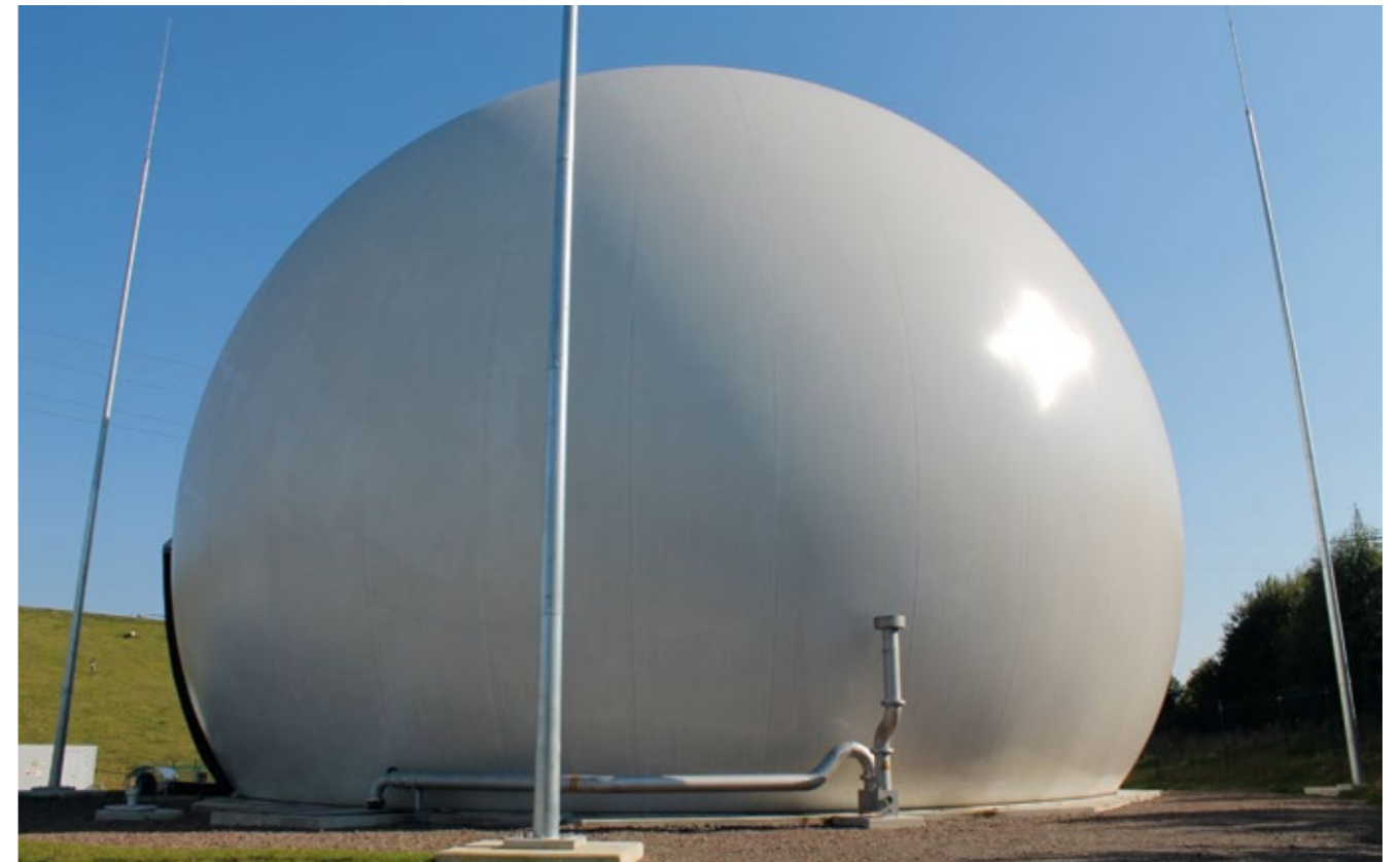
DER GASSPEICHER DES KREISES COESFELD BESITZT EIN VOLUMEN VON 7000 M 3 .
