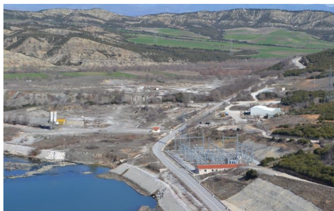
Schaltzentrale des Wasserkraftwerkes Ilarionas
